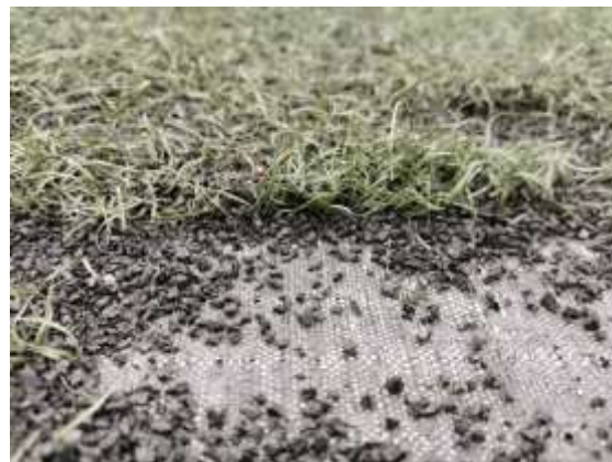
Fiberen er oppsplittet og helt nedslitt. Tilstand i målgården på Aspmyra kunstgressbane
